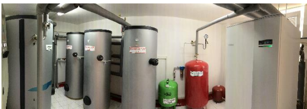
Kaskádovité propojení tří tepelných čerpadel systému vzduch-voda NIBE F2300 (vedle panelového domu v Dobrovici)
