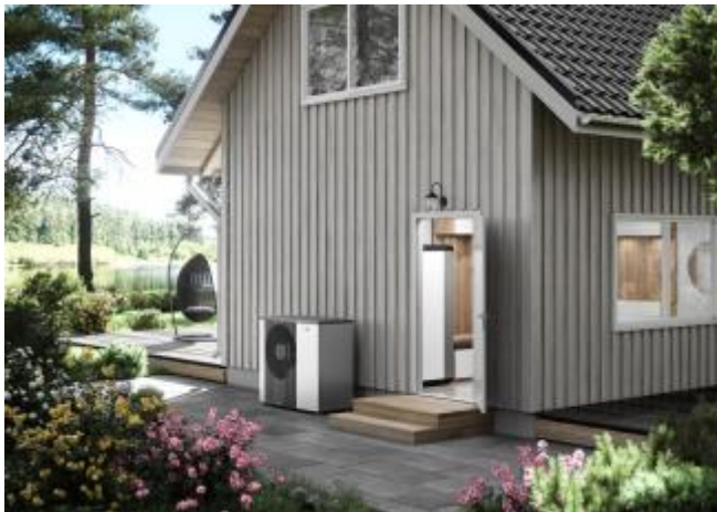
Vnitřní systémová jednotka VVM S320 a tepelné čerpadlo systému vzduch–voda NIBE F2120
