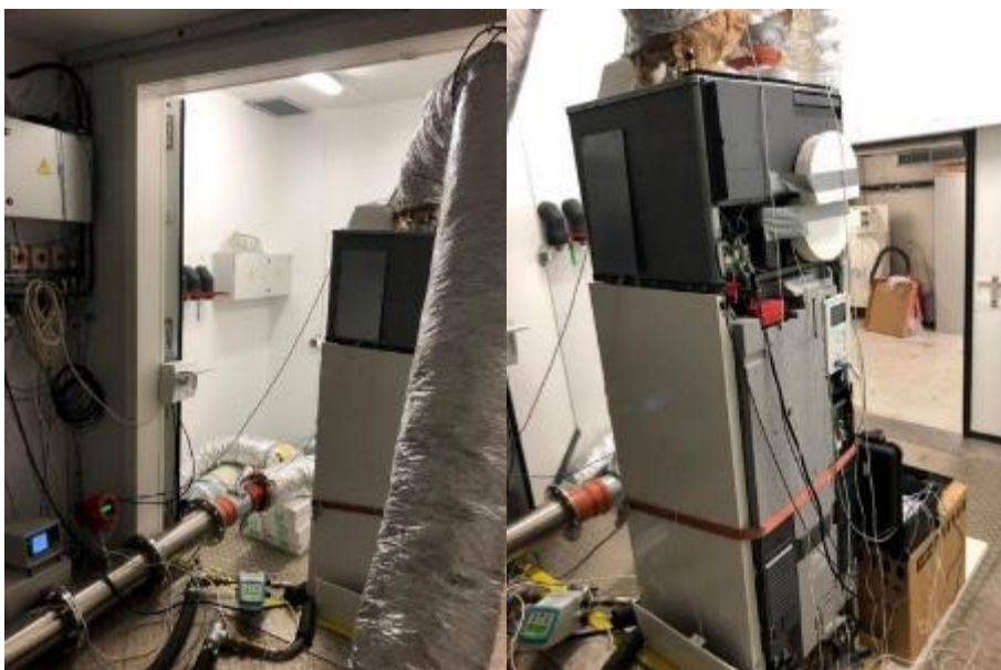
Obr. 1 – Kompaktní větrací jednotka s TČ v laboratoři tepelných čerpadel (UCEEB, ČVUT v Praze)
