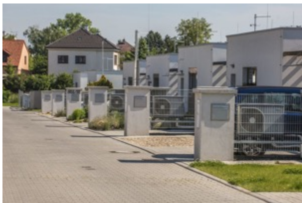
Venkovní jednotka tepelného čerpadla systému vzduch-voda NIBE F2040-6
